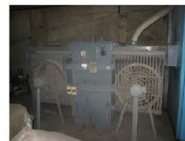
變壓器風扇停用節省電費
