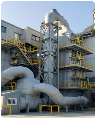
TS-3 SCR 脫硝設備
