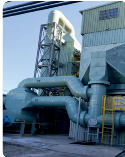
TS-7 SCR 脫硝設備
